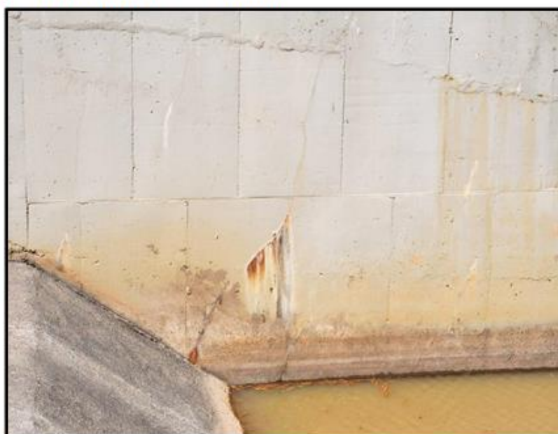
Presença de fissura no muro lateral esquerdo, com sinais de percolação.
