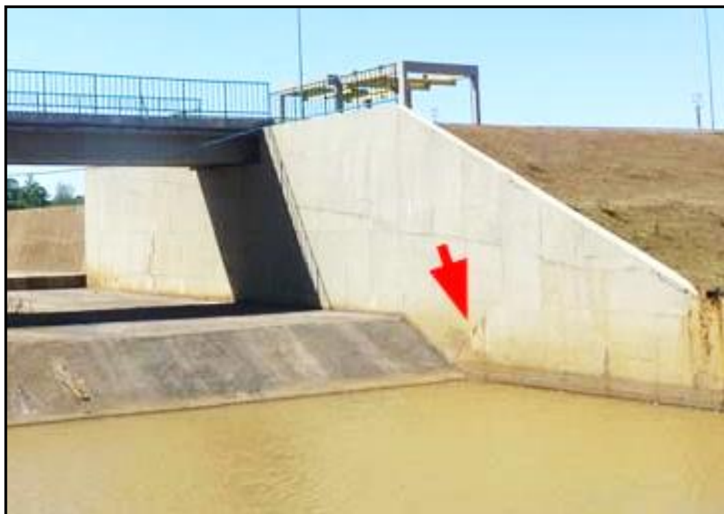
Figura 9 – Localização da fissura no muro lateral esquerdo.
