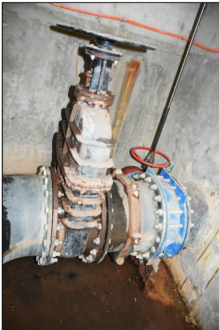
Figura 19 – Válvula tipo gaveta a montante da válvula tipo borboleta apresentando vazamento e corrosão.
