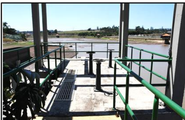
Volantes de acionamento das válvulas da tomada d'água.
