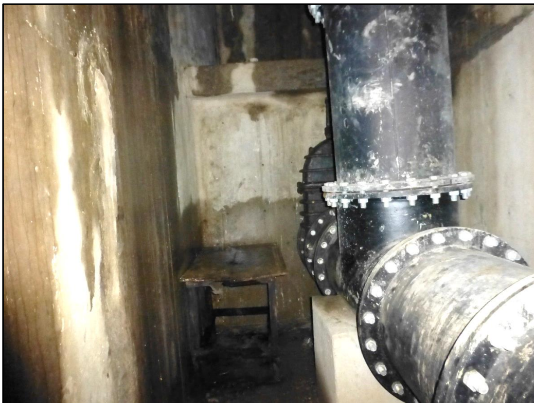
Figura 13 – Interior da galeria, na tomada-d'água, mostrando água nas paredes e no piso.
