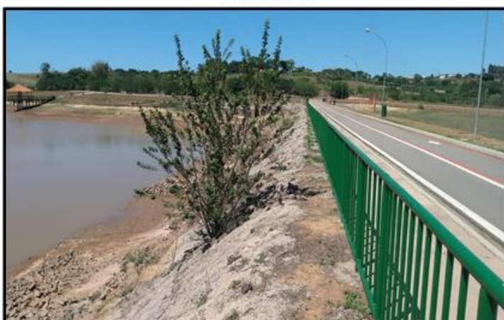
Presença de alguns arbustos no talude de montante.
