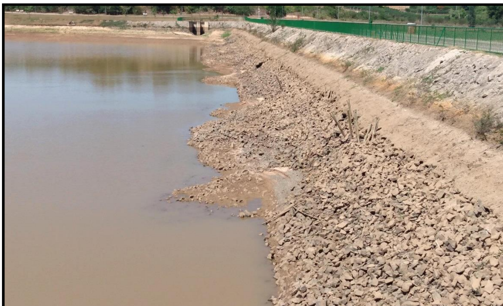
Figura 5 –Talude de montante com movimentação de porções do enrocamento de proteção.
