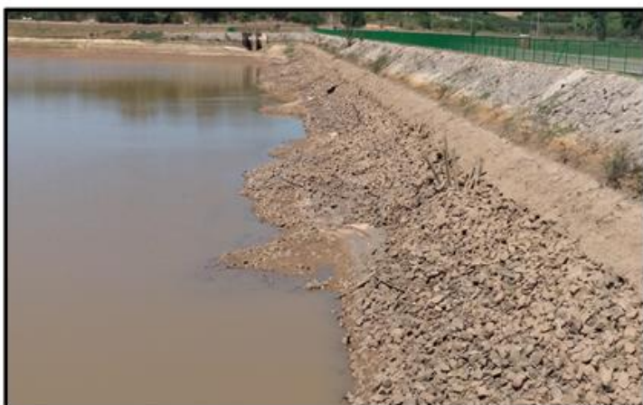
Escorregamentos superficiais da camada superficial do maciço de terra e do rip rap.
