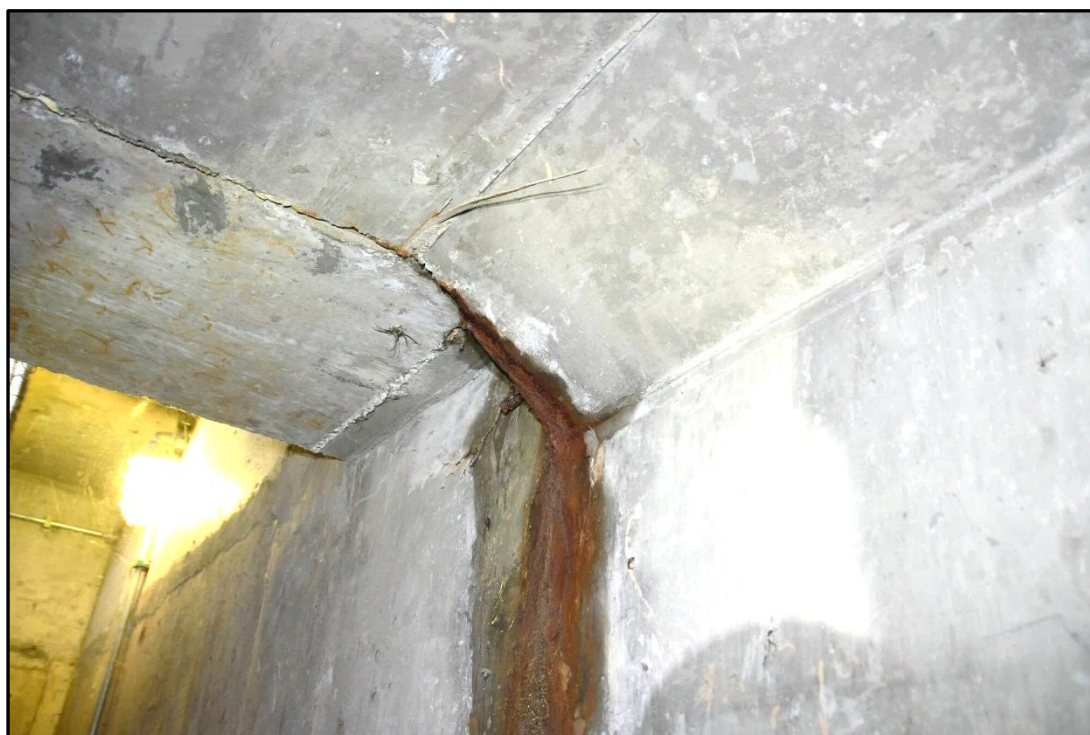
Figura 16 – Interior da galeria, próxima da tomada-d'água, mostrando vazamento por uma das juntas de concretagem.
