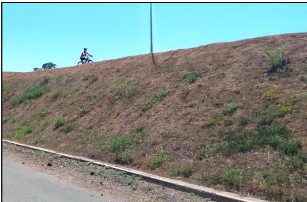
Figura 7 – Barragem – Crista com falha no revestimento primário.
