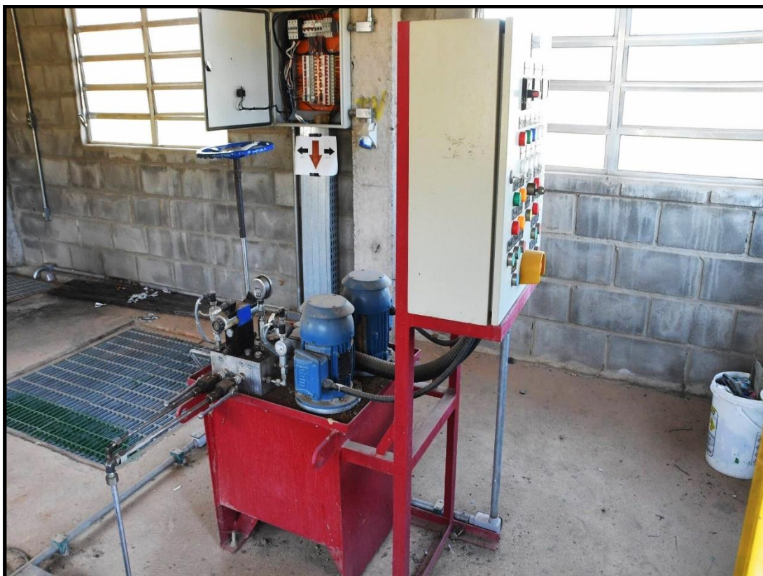
Figura 18 – Equipamento de acionamento das válvulas de jusante .
